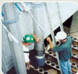
▲ 캐나다 정수 처리시설
