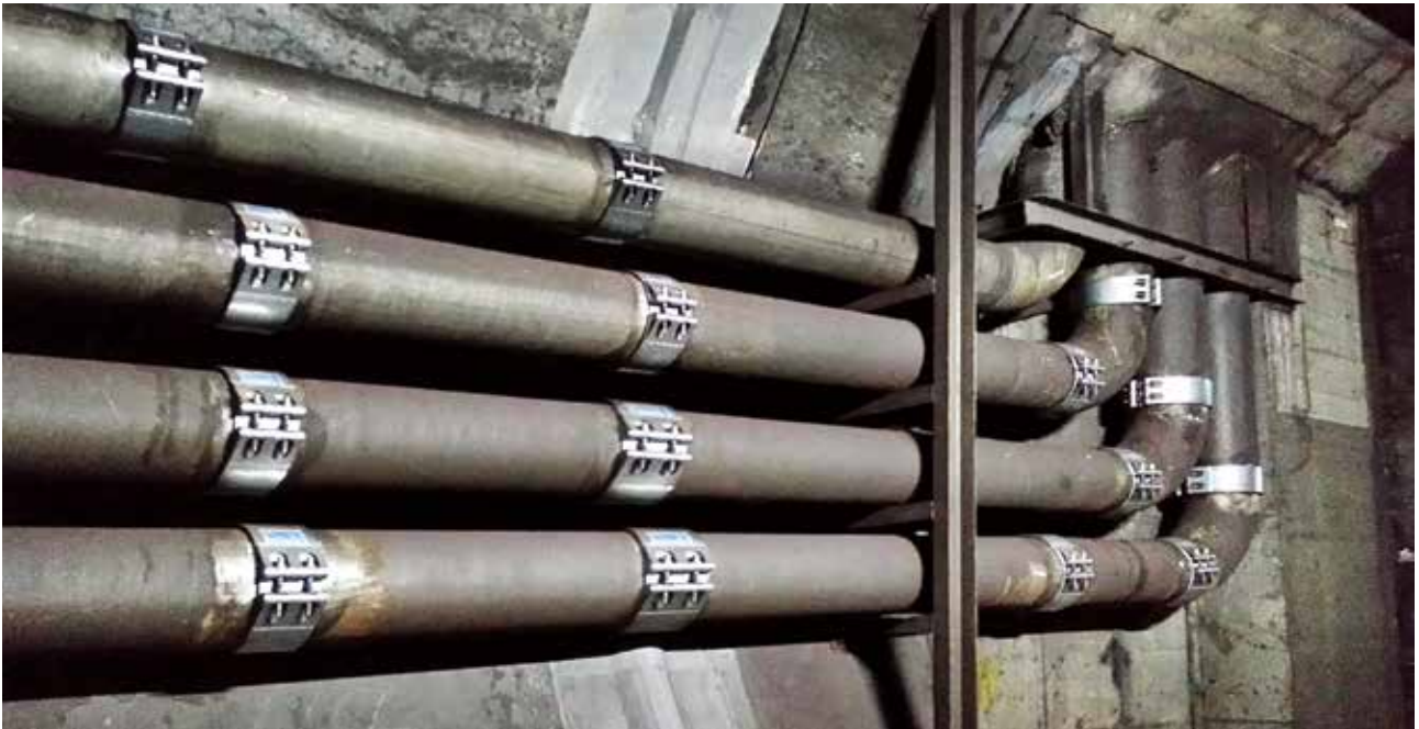
▲ 지하배수 파이프 보수공사 (용접 부위 누수)
