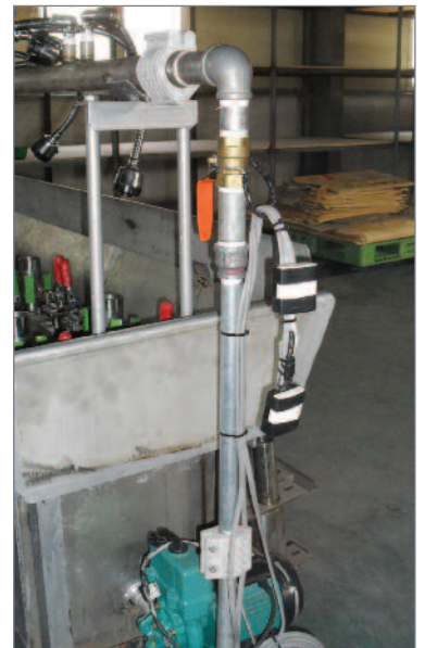
진동이 심한 기계부분의 배관
